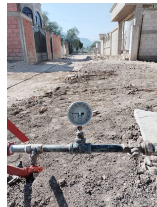
Construcción de red de agua potable, calle 3ra. Cda. 12 de diciembre Colonia el Rosario.
