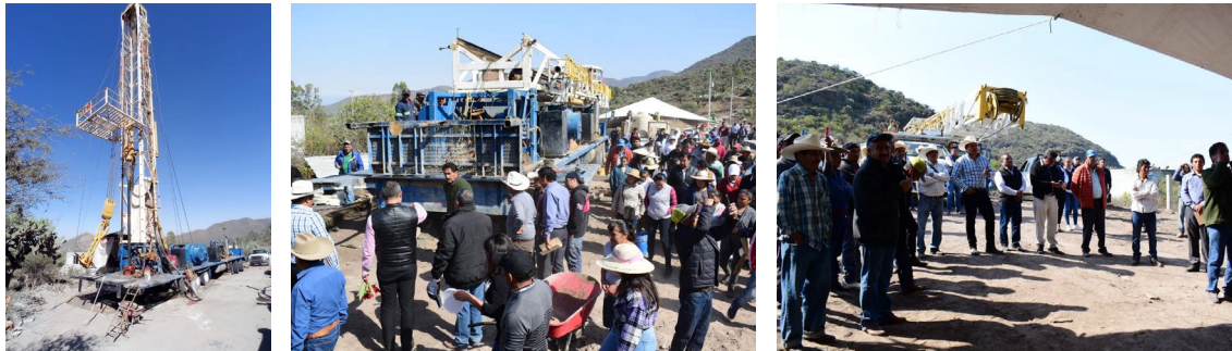
Construcción de pozo de agua potable en San Antonio, San Juan Tapa.
