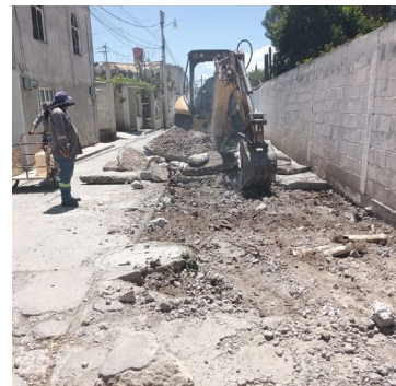
Demolición y construcción de piedras de concreto hidráulico, calle 16 De Septiembre, 3ra. Demarcación.
