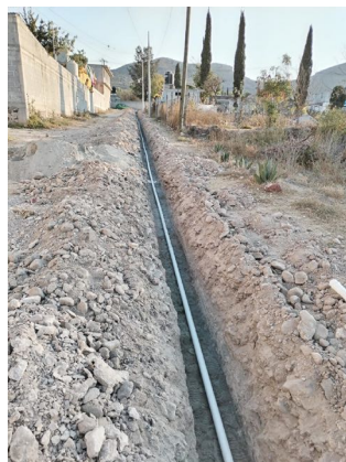
Construcción de red de agua potable: Calle Abelardo I. Rodríguez, Col. San Antonio.
