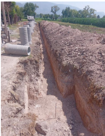
Drenaje sanitario, Cda. Sin Nombre.
